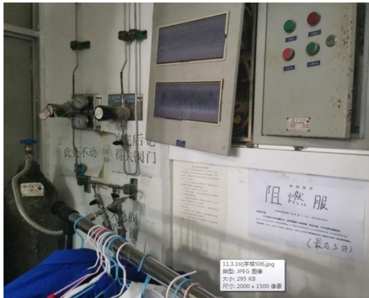
配电箱周围杂物遮挡，不便于操作
