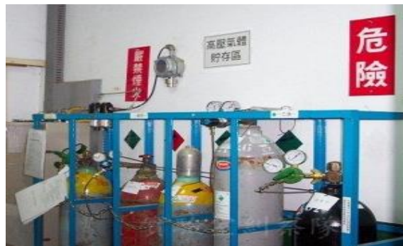
易燃气体、助燃气体混放
