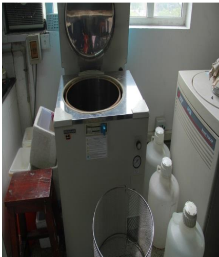
压力容器没有张贴操作规程；没有安全警示标识
